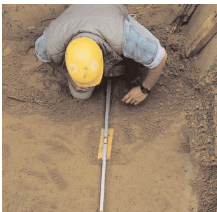
1. Aufstandsbereich des Schachtbodens analog zur DIN EN 1610 vorbereiten, Planum erstellen und Schachtboden positionieren.
