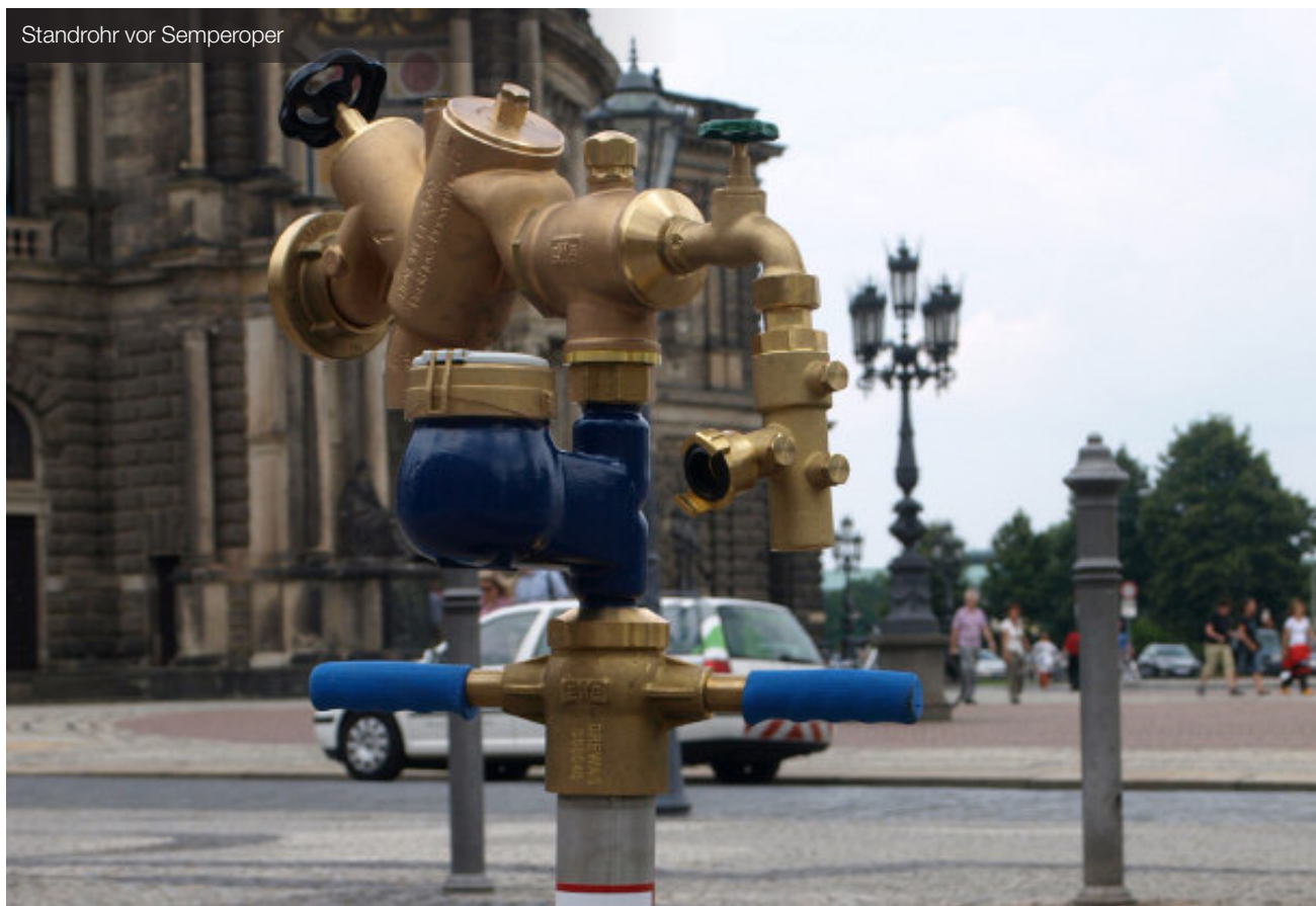
Quelle: DREWAG Netz GmbH
