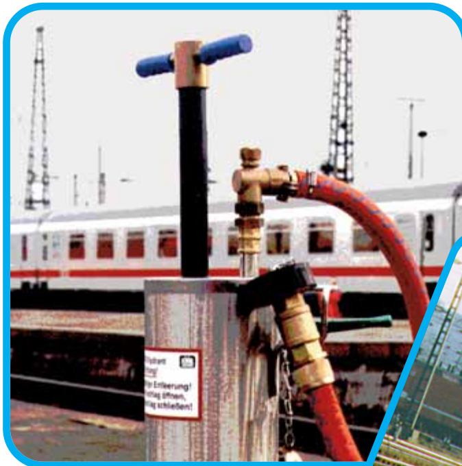
Trinkwasser-Befüllhydrant, DB-Ausführung auf dem Gelände des Bahnhofs Leipzig
